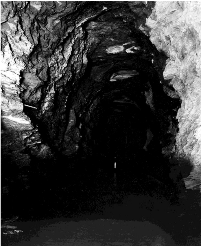
Bild 3: Das von den Tirolern ausgebrochene Tunnelgewölbe in der Wangformation unter der Talacheri 5 . Die Breite des Ausbruches betrug ca. 1.8 m und die Höhe ca. 3.6 m. Die Tiroler haben in 2 Jahren die ganze Strecke von ca. 100 m ausgebrochen, was ca. 650 m 3 oder 1800 t Gestein entspricht. Auffallend ist die relativ schwache Strömung des Wassers. Das Foto entstand vor der Aufweitung des Rudenzer Stollens im Jahre 1923.
