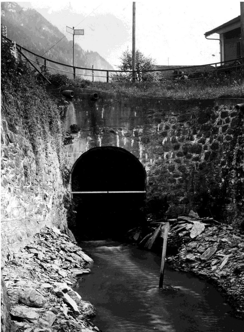
Bild 4: Alter Stollenauslauf Richtung Norden, wie er im Jahre 1767 erstellt wurde. Die Sohle des Stollenauslaufes wurde im Jahre 1850 bei der Entsumpfung des Aarieds ca. 1 m tiefer gelegt um das Gefälle zu erhöhen. Im Jahre 1900 wurde hier Wasser ausgeleitet zum Betrieb einer Uhrensteinschleiferei sowie zur Stromerzeugung für das Hotel Krone. Der Bauschutt im Vordergrund sind die Überreste des Kanals. Dieser musste beim Ausbau des Lungerersee - Kraftwerkes im Jahre 1923 beseitigt werden. Kurz nach dieser Aufnahme wurde das Profil des Stollens wesentlich vergrössert.
