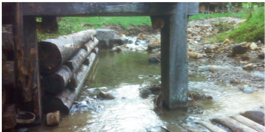
... als Gefahrenbereich für die «Chluis» (Triftklause), wo Tor und Verschluss weggerissen sind
