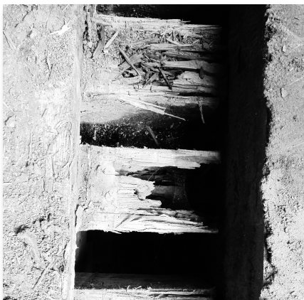
Schäden am Unterbau
